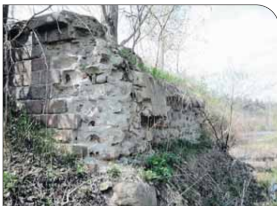
Fragmenty przyczółku mostowego w Rembelszczyźnie
